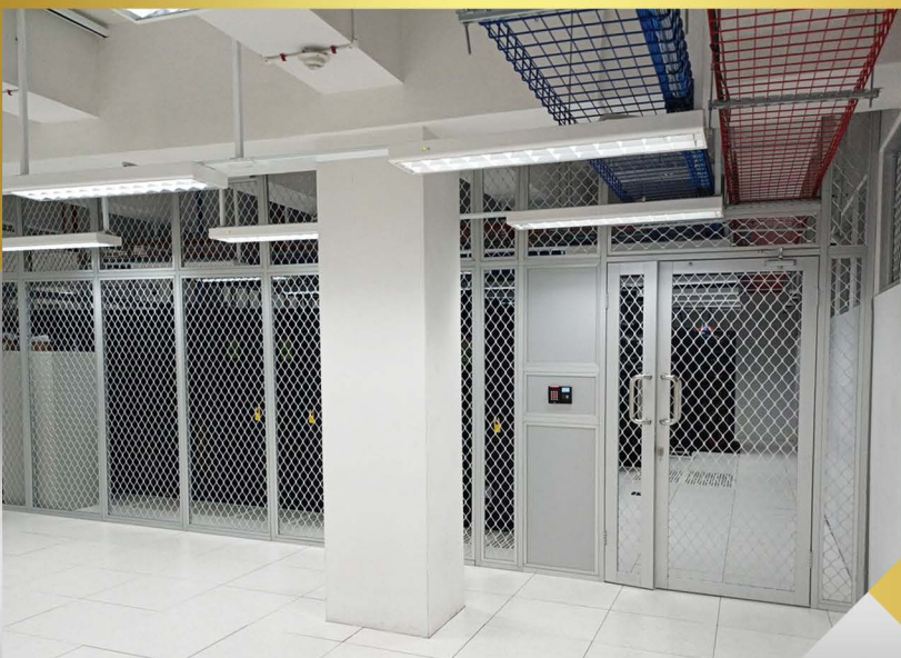
Data Center Pegadaian, Sentul
