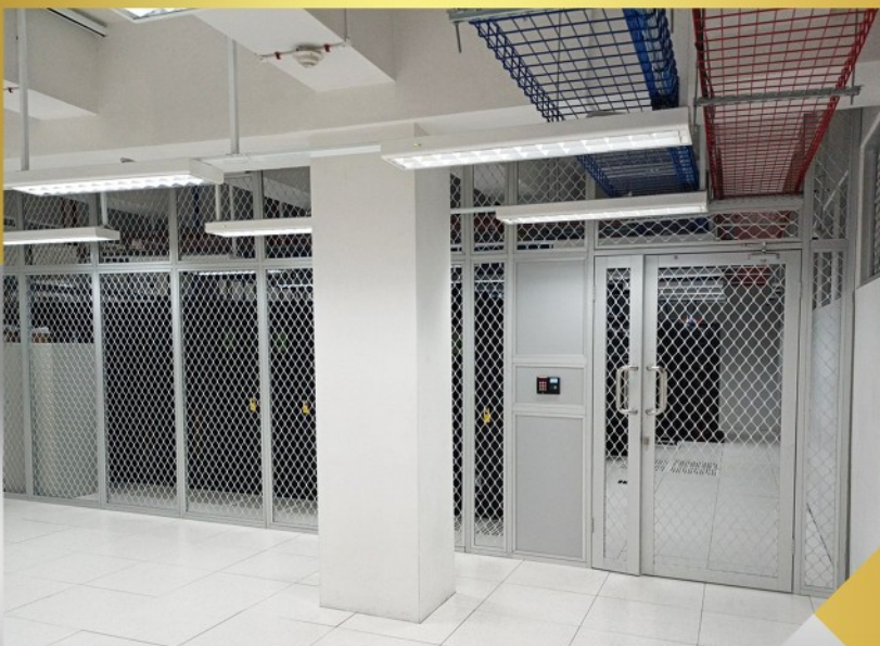
Data Center Pegadaian, Sentul
